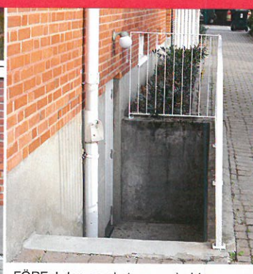
FÖRE: I den gamla trappen leddes vattnet från stupröret direkt till valningarna under jord – ledningar som ofta täpps igen eller går sönder av ålder.
